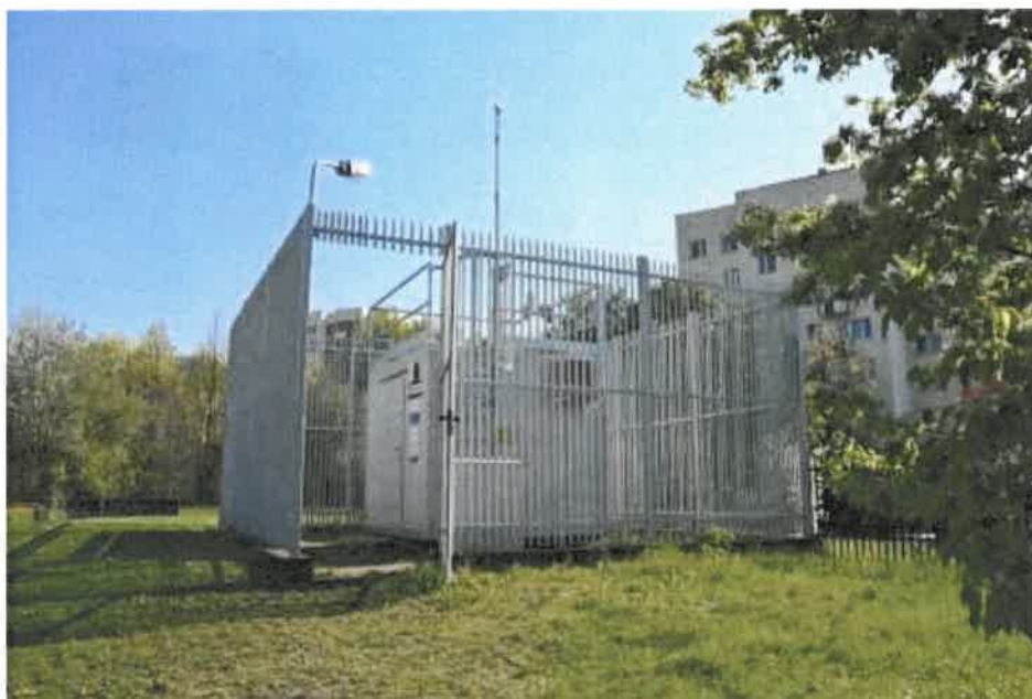
Rysunek 14. Stacja monitoringu – ul. Wokalna w Warszawie
